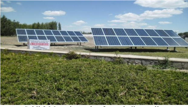
Şekil 2 Montajı yapılan fotovoltaik paneller Figure 2 Mounted photovoltaic panels
