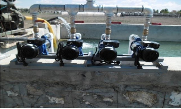
Şekil 3 Pompaların havuzun üstüne montajı Figure 3 Installation of pumps on top of the pool
