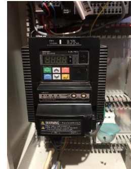
Şekil 6. Frekans İnvörtörü Figure 6. Frequency inverter
